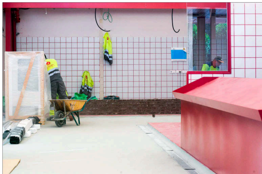
Los trabajos de los diferentes oficios van acondicionando los puestos. TOMÁS ALONSO
