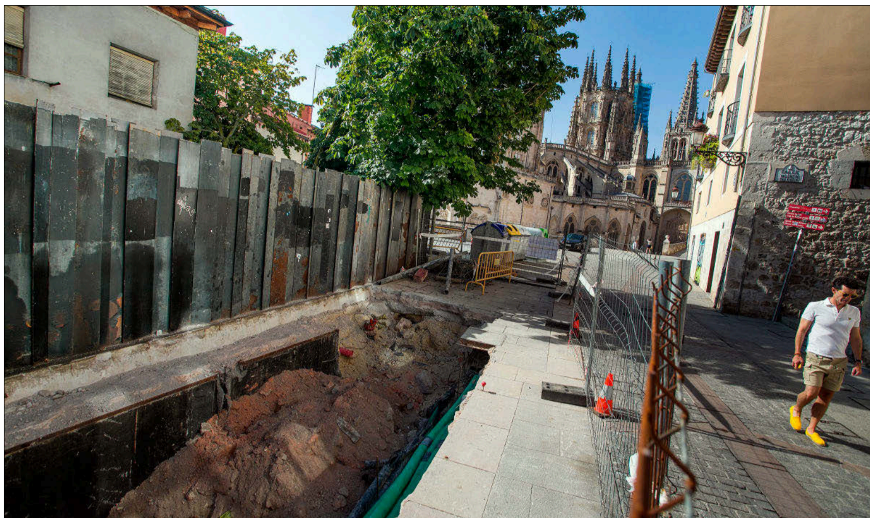
Excavación en la calle Fernán González donde se colocará una isla completa tras eliminarse la de la plaza de los Castaños. TOMÁS ALONSO
